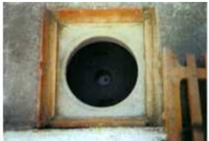
Gassperre richtig engesetzt
